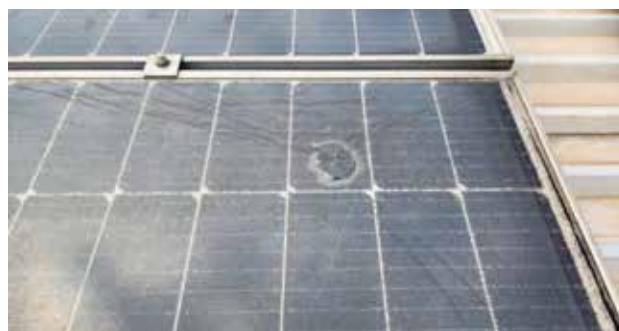
Hình 37: Một số hư hỏng trên tấm quang điện
