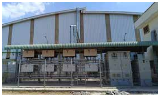
Hình 5: Biến tần và khu vực đặt biến tần
