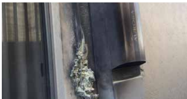
Hình 41: Biến tần bị cháy, hư hỏng
