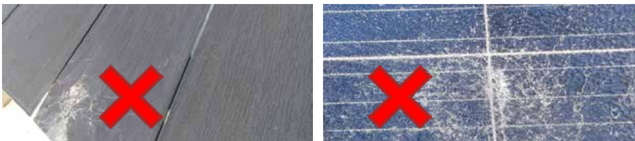
Hình 30: Không được vệ sinh tấm quang điện bị hư hỏng
