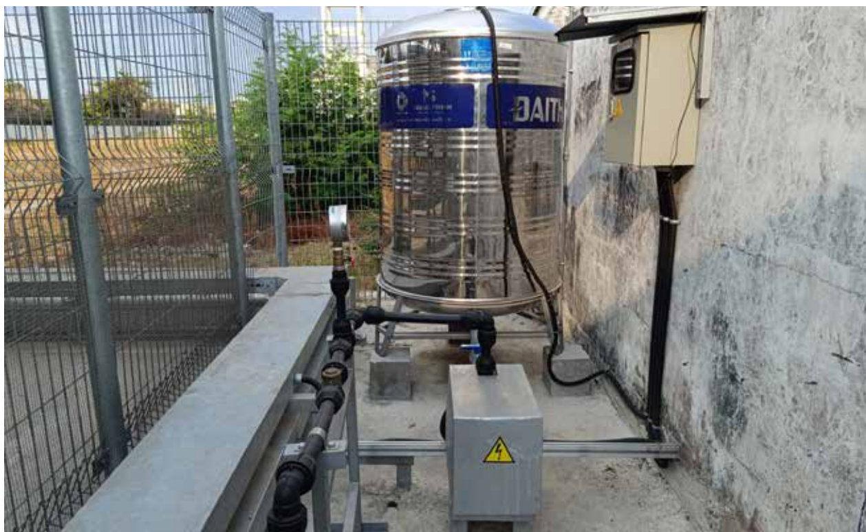
Hình 29: Bồn trữ nước sạch & máy bơm để vệ sinh tấm quang điện
