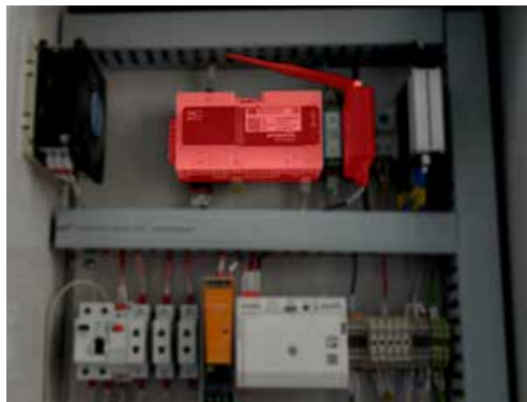
Hình 13: Bộ ghi dữ liệu (trái) và modem 4G (phải) lắp đặt trong tủ thông tin
