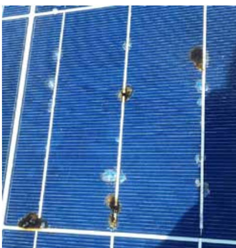
Hình 32: Tấm quang điện bị bóng cây che và hiện tượng hotspot
