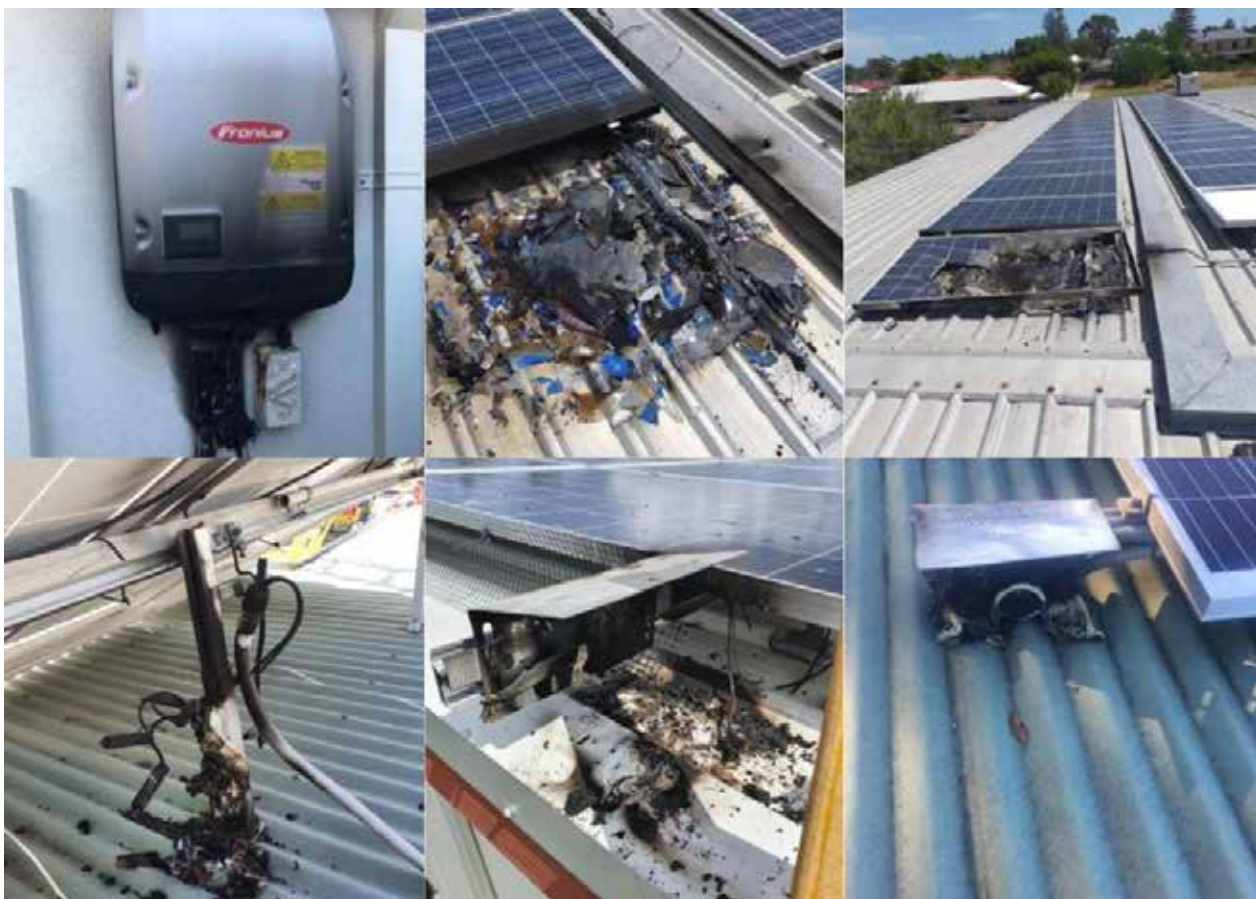
Hình 55: Tấm quang điện, biển tần và các thiết bị khác bị cháy, nổ
