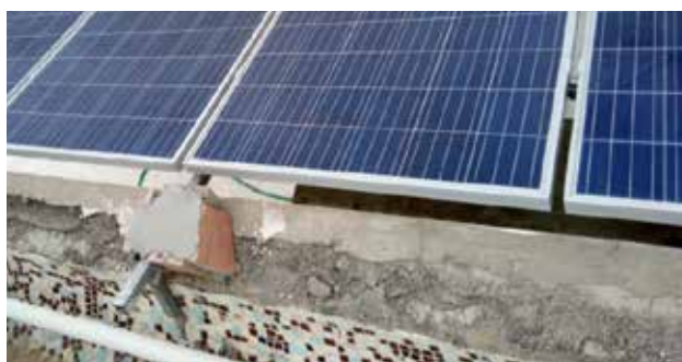
Hình 38: Khung giá đỡ lắp đặt không đảm bảo
