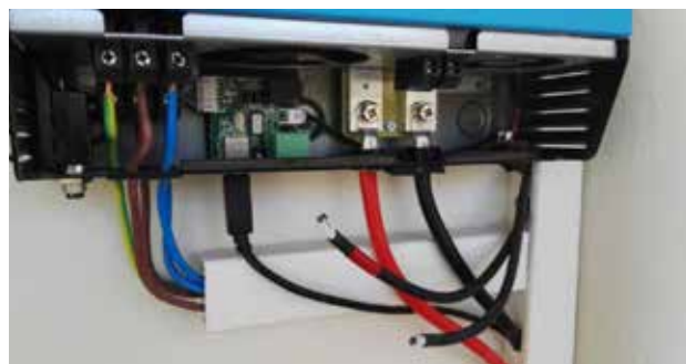
Hình 42: Dây cáp bị tuột khỏi biến tần
